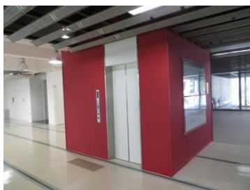
エレベーター
